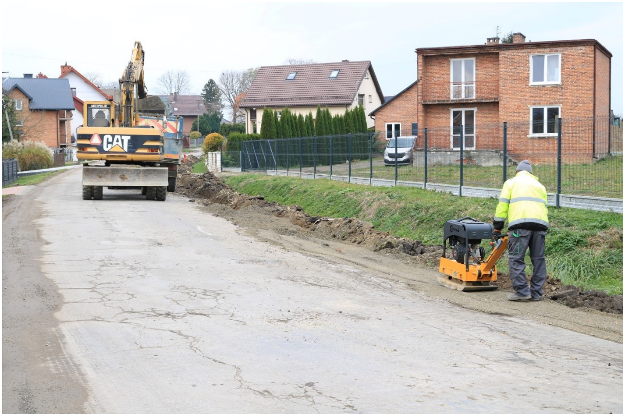
Fot.8. Remont drogi powiatowej nr 2743L w miejsc.Polichna i Huta Józefów (gm.Szastarka)
